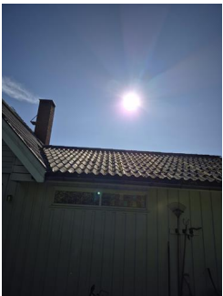
Helhetsvurdering - Eksempel på yttertak.
