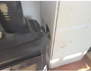
Ildsteder - Ildsted ikke tilkoblet.
