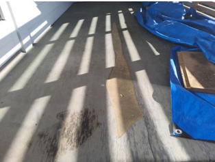
Membraner og vanntett sjikt - Skade i membran/tettesjikt på del av balkongen over oppvarmet rom.
