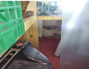
Overflate vegg - Eksempel på fuktmerker/saltutslag på synlig murvegg.
