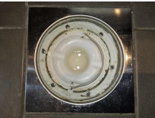
Avløp (inkl. sluk) - Sluk vaskerom
