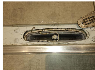
Avløp (inkl. sluk) - Sluk bad 1.etasje
