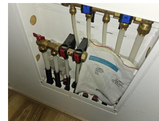
Fordelerskap og fordelerstammer - Fordelerskap for rør-i-rør-systemet 2. etasje
