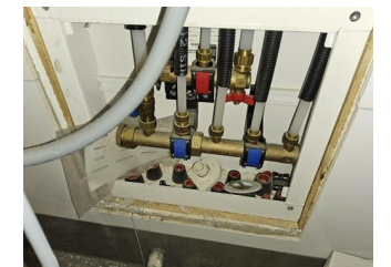
Fordelerskap og fordelerstammer - Fordelerskap for rør-i-rør-systemet bad underetasje
