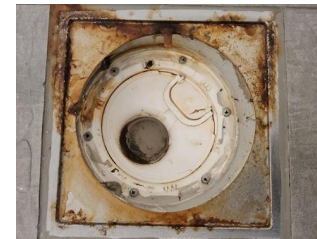
Avløp (inkl. sluk) - Sluk bad underetasje
