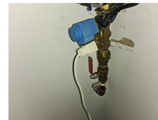
Vannrør (utover det som nevnes under andre sjekkpunkter) - Vanninntaksrør med hovedstoppekran
