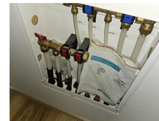
Fordelerskap og fordelerstammer - Fordelerskap for rør-i-rør-systemet 2. etasje
