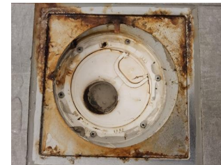
Avløp (inkl. sluk) - Sluk bad underetasje
