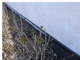
Fuktsikring av grunnmur - Løs fuktsikring på grunnmur
