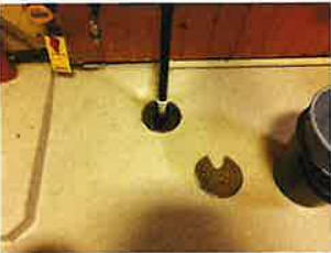
Tettesjiktets tilslutning til sluk - Sluk
