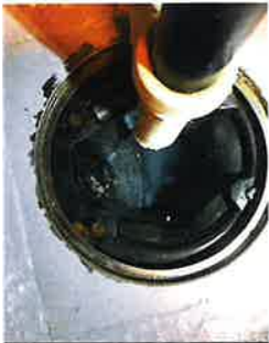
Tettesjiktets tilslutning til sluk - Sluk
