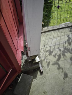
Konstruksjon og fundamenter - Eksempel på utglidning av søylefundament.
