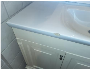
Sanitærutstyr og innredning - Hakk i servant.
