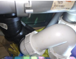
Vannrør - Vannrør uten plugg mot varerør.
