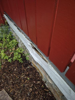
Konstruksjon og fundamenter - Råteskader i forkantbord ved inngangspart.
