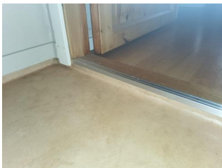
Lekkasjesikkerhet - Oppkant ved dørterskel.
