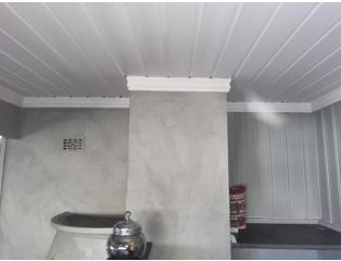
Overflate himling - Eksempel på synlige skjevheter i himling.
