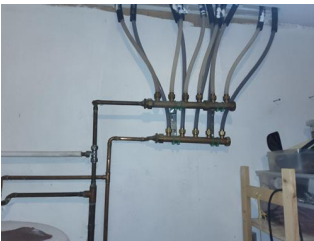
Fordelerskap og fordelerstammer - Fordelerstammer for rør-i-rør.
