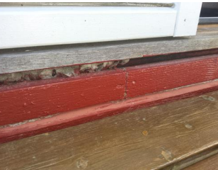
Ytterdører og omramming - Manglende beslag under balkongdør 2.etasje.
