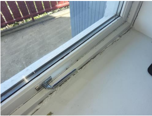
Annet - Sprekk i vinduskarm på soverom.
