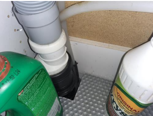
Vannrør - Eksempel på vannrør uten tetting mot varerør.
