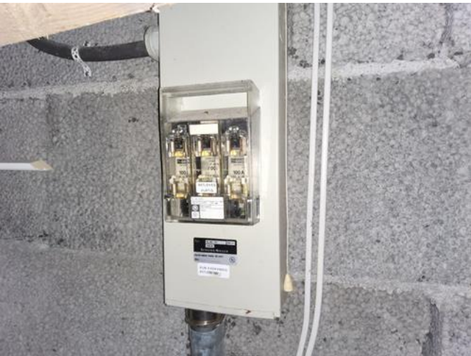
Elektrisk anlegg - [Sikringsboks ]
