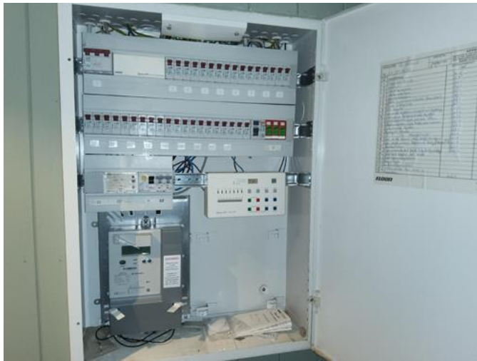
Elektrisk anlegg - [Sikringskap ]
