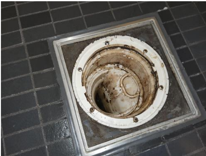
Våtrom - [Sluk på bad i 1.etg]
