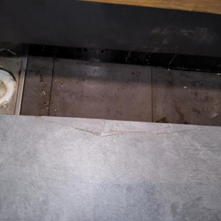
Overflater gulv - Skade i flis ved jacuzzi
