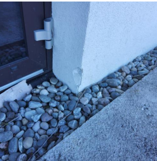
Grunnmur og fundament - Skade på mur
