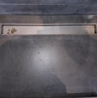
Overflater gulv - Sluk og sprekker i flis i dusjsonen
