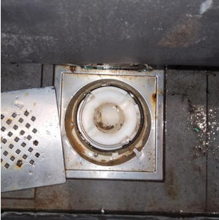
Avløp (inkl. sluk) - Sluk og vann på gulv ved jacuzzi
