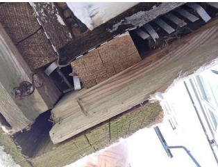
Gnagersikring - Utilstrekkelig utførelse på gnagersikring
