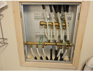
Fordelerskap og fordelerstammer - Fordelerskap for rør-i-rør-systemet
