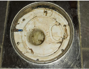
Avløp (inkl. sluk) - Sluk bad underetasje
