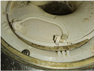
Avløp (inkl. sluk) - Sluk bad 1.etasje
