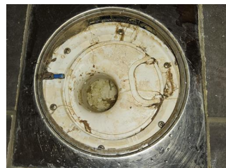
Avløp (inkl. sluk) - Sluk bad underetasje
