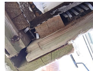
Gnagersikring - Utilstrekkelig utførelse på gnagersikring
