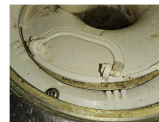
Avløp (inkl. sluk) - Sluk bad 1.etasje
