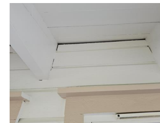
Takkonstruksjon - Eksempel på luftespalte av for liten størrelse
