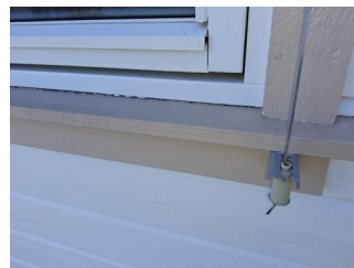
Vinduer og omramming - Eksempel på manglende vannbrettbeslag under vindu
