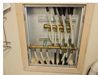
Fordelerskap og fordelerstammer - Fordelerskap for rør-i-rør-systemet
