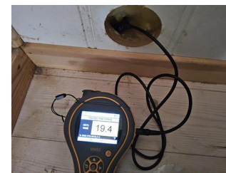
Kontroll i lukkede konstruksjoner - Fuktmåling i utlekket kjellervegg
