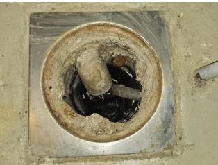
Vannrør - Sluk vaskerom
