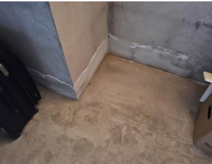
Overflate vegg - Kalk/saltutslag på vegger
