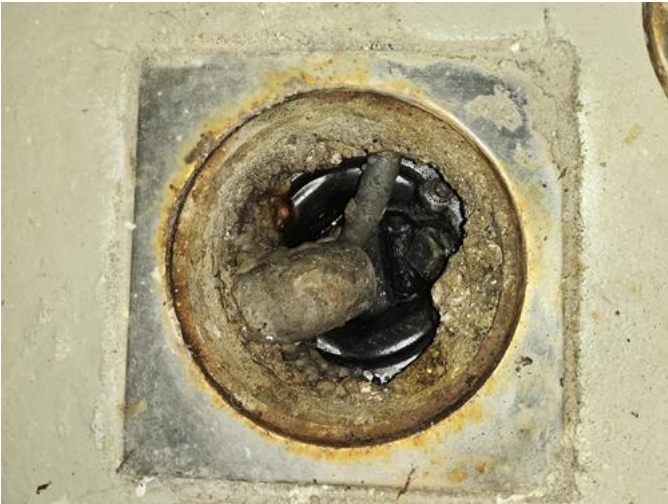
Avløpsrør (ink. sluk) - [Sluk vaskerom]
