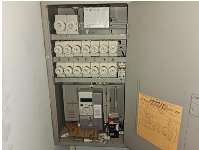
Elektrisk anlegg - [Sikringsskap]
