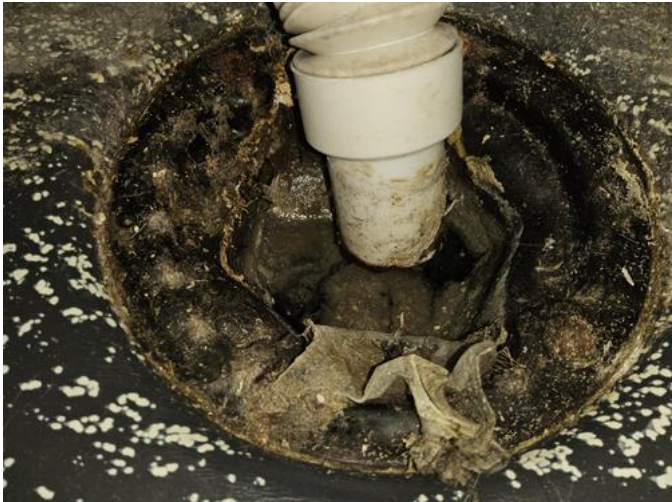
Avløpsrør (ink. sluk) - [Sluk bad]
