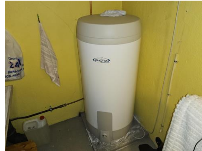
Tekniske anlegg, VVS anlegg (Sjekkpunkter utover det som er inkludert i andre rom) - [Varmtvannsbereider]
