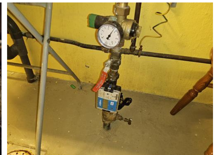
Tekniske anlegg, VVS anlegg (Sjekkpunkter utover det som er inkludert i andre rom) - [Vanninntaksrør med hovedstoppekran]
