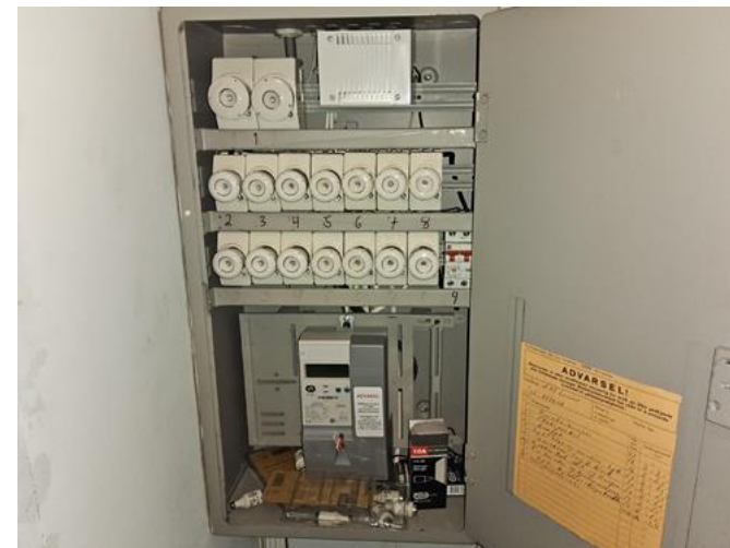
Elektrisk anlegg - [Sikringsskap]
