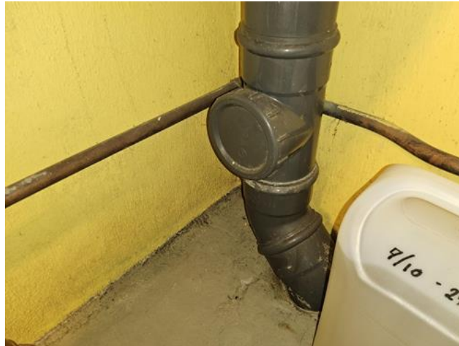
Tekniske anlegg, VVS anlegg (Sjekkpunkter utover det som er inkludert i andre rom) - [Stakeluke]
