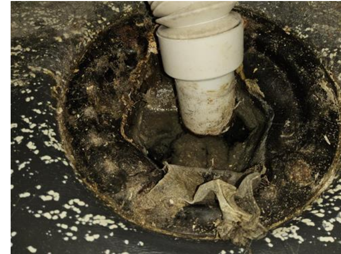
Avløpsrør (ink. sluk) - [Sluk bad]
