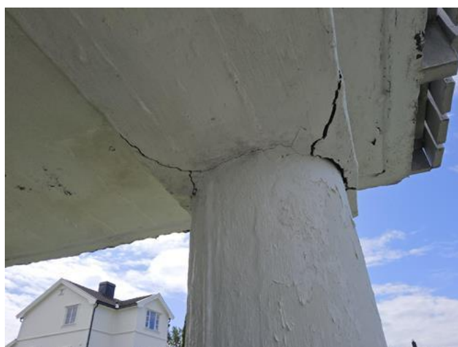
Balkonger, terrasser, veranda etc - [Sprekker i bærende konstruksjon altan]
