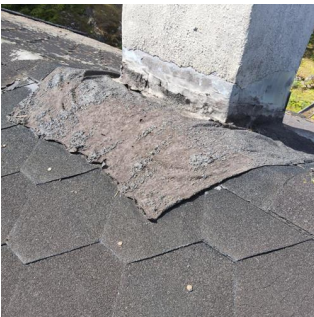
Helhetsvurdering - Eksempel på slitasjer og ufermessig utførelse
