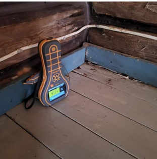
Helhetsvurdering - Eksempel på råteskader og fuktmåling
