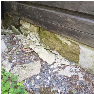
Grunnmur og fundament - Eksempel på slitasjer
