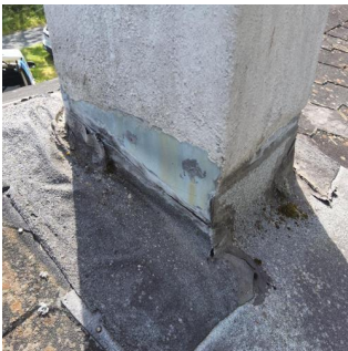
Helhetsvurdering - Eksempel på slitasjer og utettheter ved pipe mot sør
