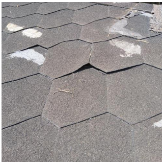
Helhetsvurdering - Eksempel på slitasjer, utettheter og mulig underliggende skader ved pipe mot sør
