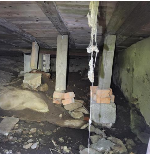
Helhetsvurdering - Krypkjeller med fuktproblematikk
