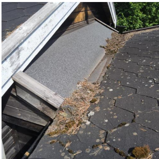
Helhetsvurdering - Eksempel på slitasjer og ufermessig utførelse
