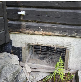
Helhetsvurdering - Eksempel på slitasjer, råteskader og spor etter skadedyr
